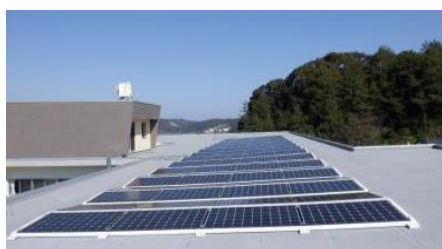
太陽光発電設備整備事業
