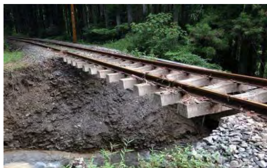
「築堤崩壊」の様子
