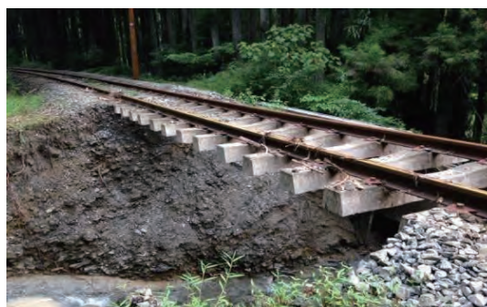
「築堤崩壊」の様子
