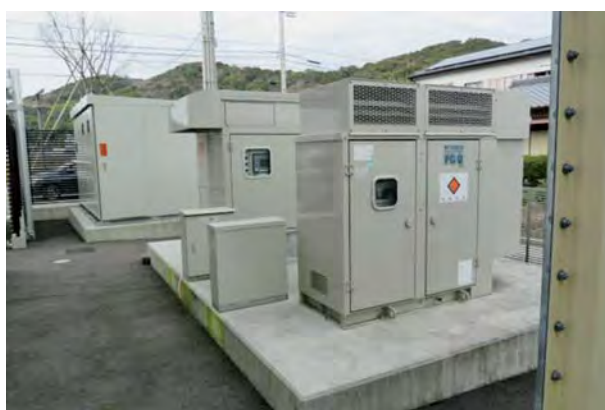
▲ 社外にある非常用発電装置
