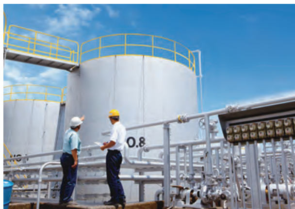
▲ 石油関連事業 第三油槽所内のタンク
