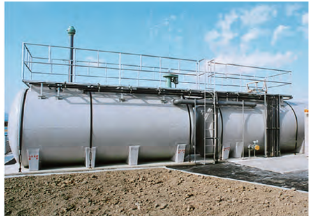
▲排水処理施設
