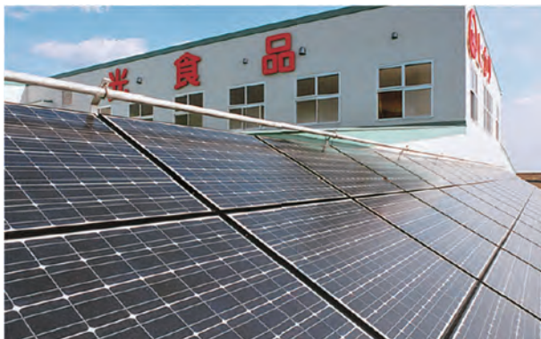
▲太陽光発電システム
