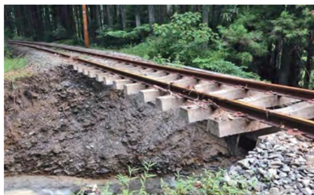
「築堤崩壊」の様子
