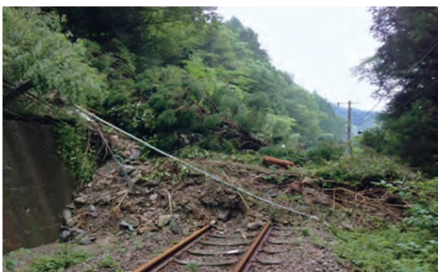
「土砂崩壊」の様子
