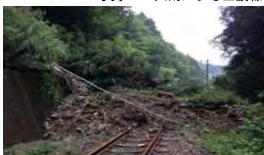
「土砂崩壊」の様子
