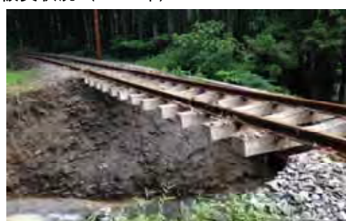
「築堤崩壊」の様子
